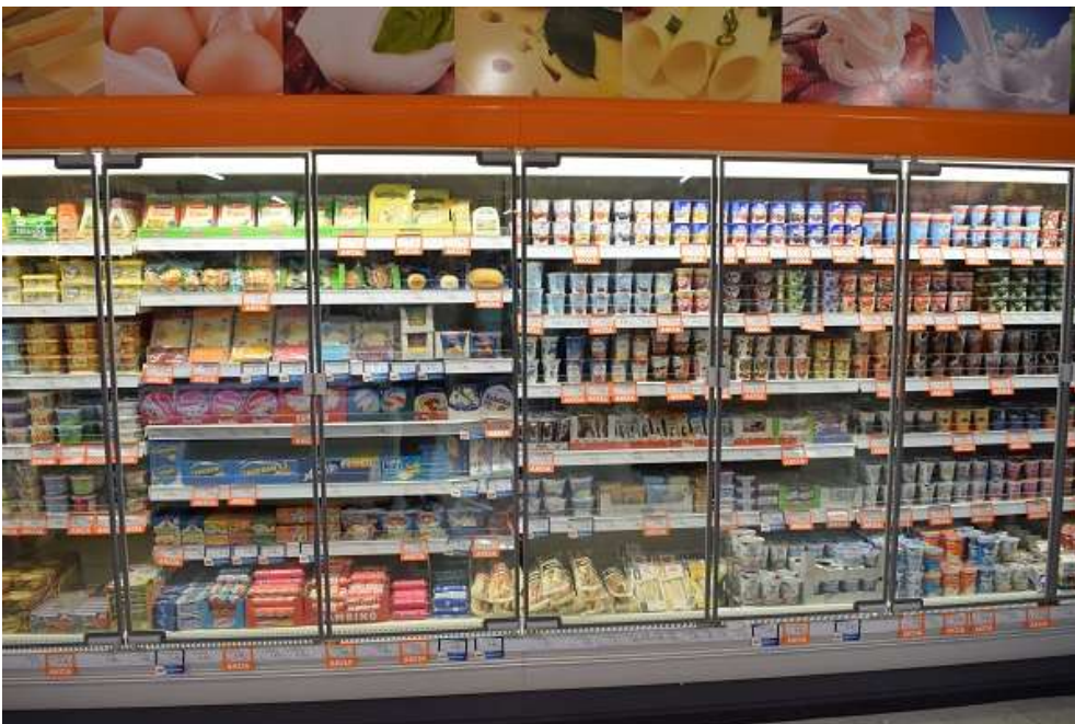
Interiér nového supermarketu č.143, vybudovaného v roku 2017 v obci Mužla. Moderné chladiace a mraziace zariadenia prináša ekologickú pridanú hodnotu.
